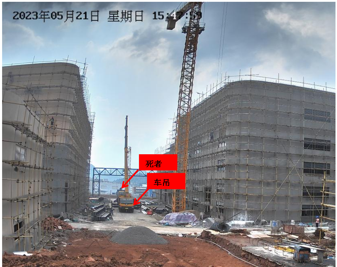
事故现场照片
